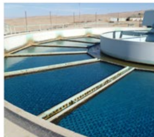
Planta potabilizadora Calama (750 L/s)
