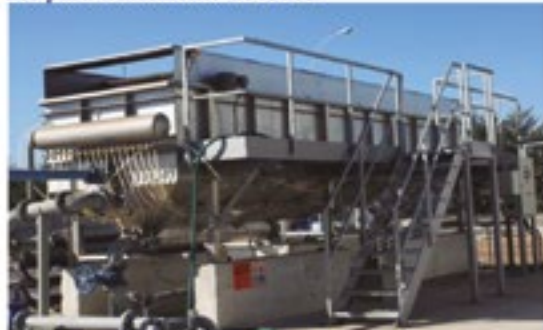
DAF 60 m 3 /h para espesamiento de lodos en PTAS Rengo
